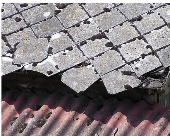
Rys. 8. Pokrycie dachowe ocenione w I stopniu pilności.
