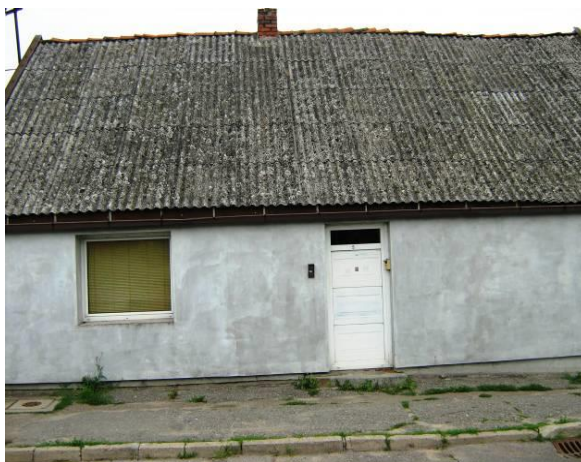
Rys. 7. Pokrycie dachowe ocenione w II stopniu pilności.
