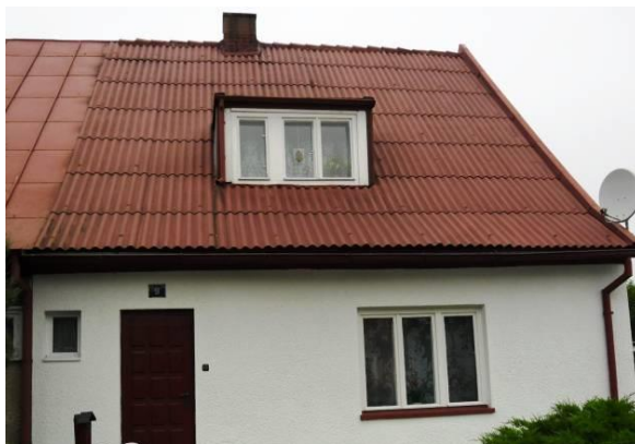
Rys. 6. Pokrycie dachowe ocenione w III stopniu pilności.
