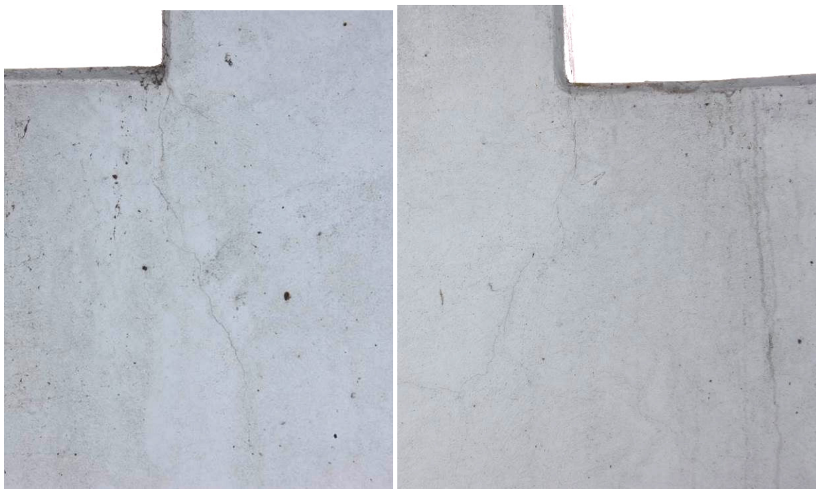
Rys. 3.22. Lokalne pionowe zarysowania górnej części korpusu podpory nr 4 – rozwartość do 0,2 mm
