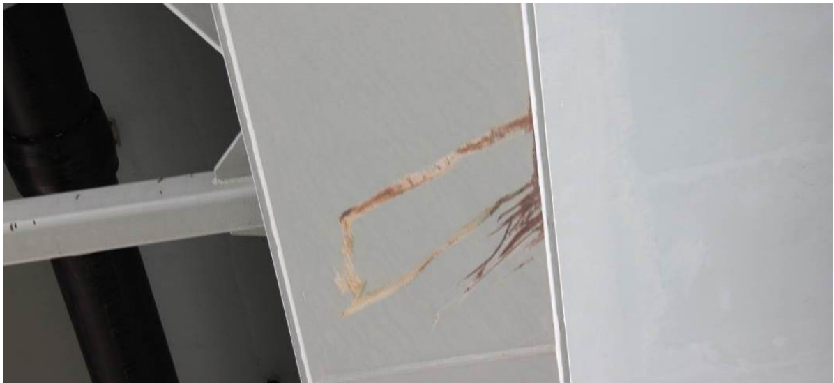
Rys. 3.3. Mechaniczne uszkodzenia powłok antykorozyjnych zabezpieczających dolny pas dźwigara głównego od strony górnej wody w przęśle 4-5
