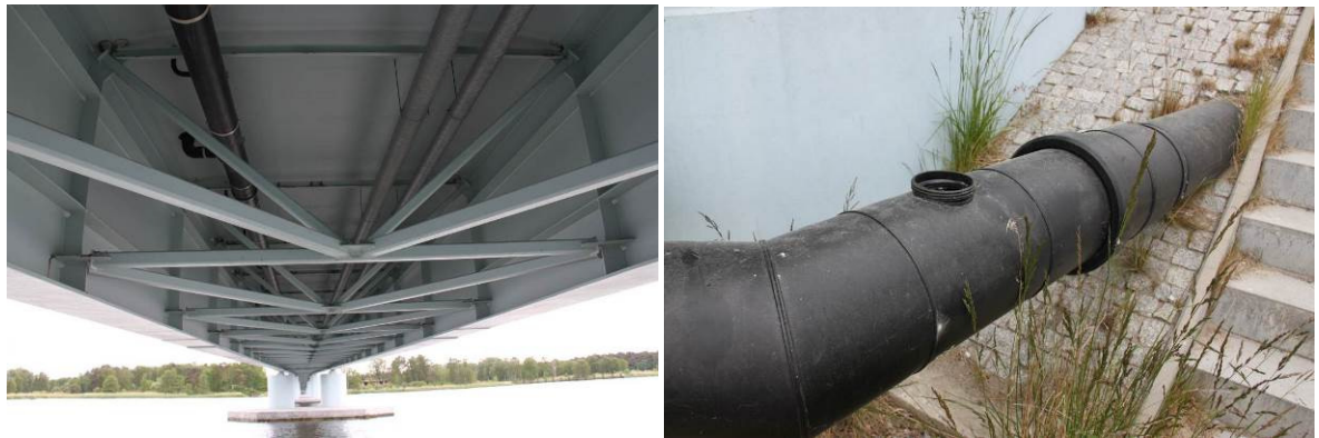
Rys. 3.33. Kolektor odprowadzający wody opadowe: na długości przęsła (po lewej) oraz przy podporze nr 1 (po prawej) – brak pokrywy otworu rewizyjnego (we wnętrzu kolektora są zanieczyszczenia)
