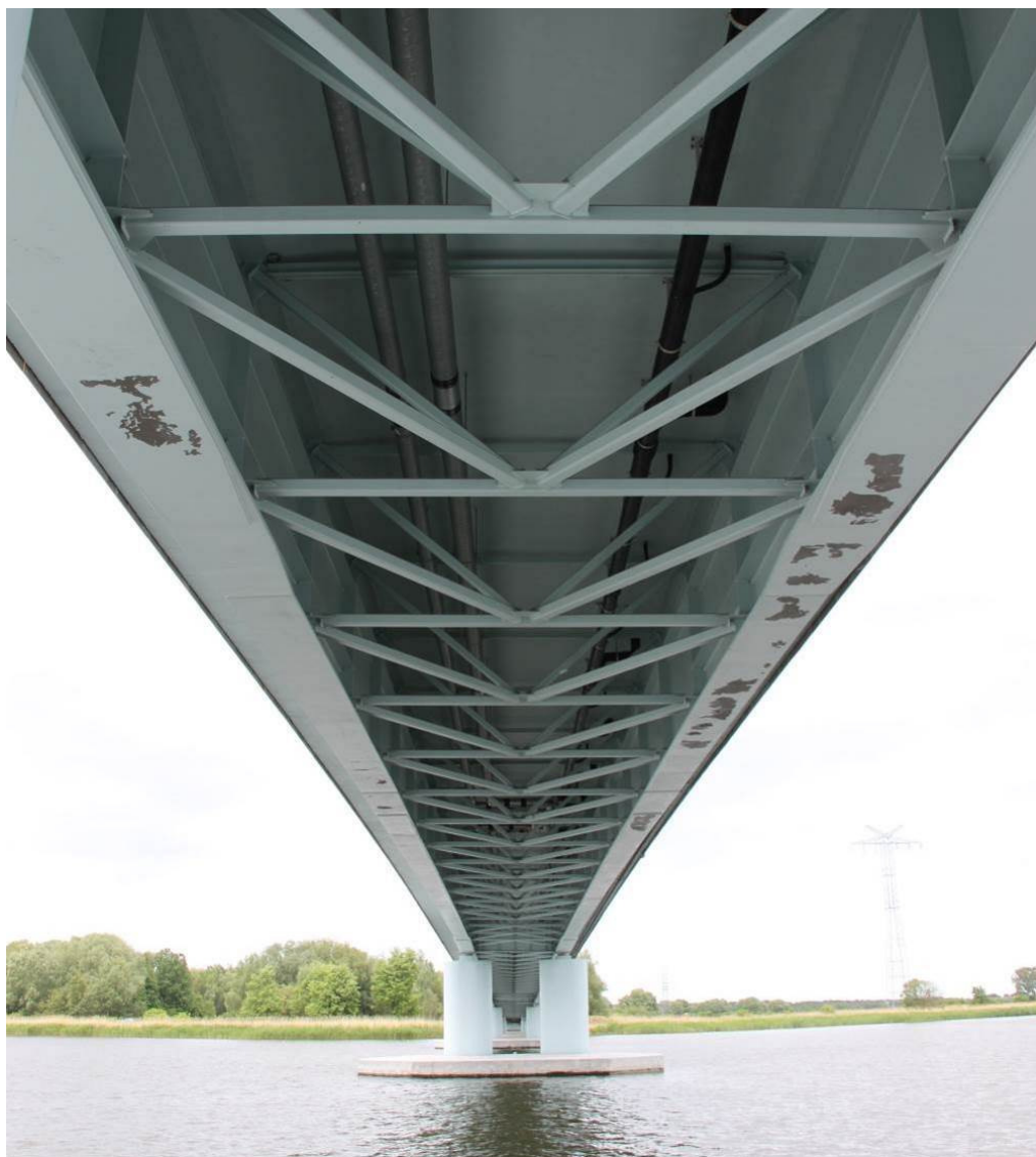
Rys. 3.4. Ubytki zewnętrznej warstwy powłoki antykorozyjnej – widok ogólny z poziomu rzeki na dolne pasy dźwigarów głównych w przęśle 6-7
