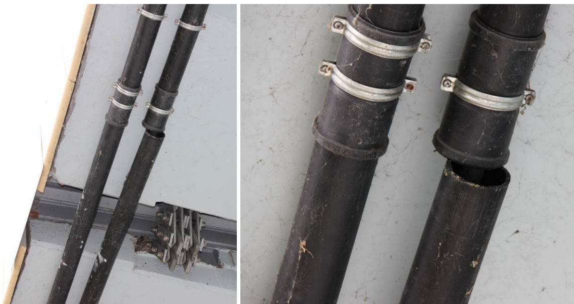
Rys. 3.48. Rozłączenie elementów rury osłonowej w rejonie podpory nr 9
