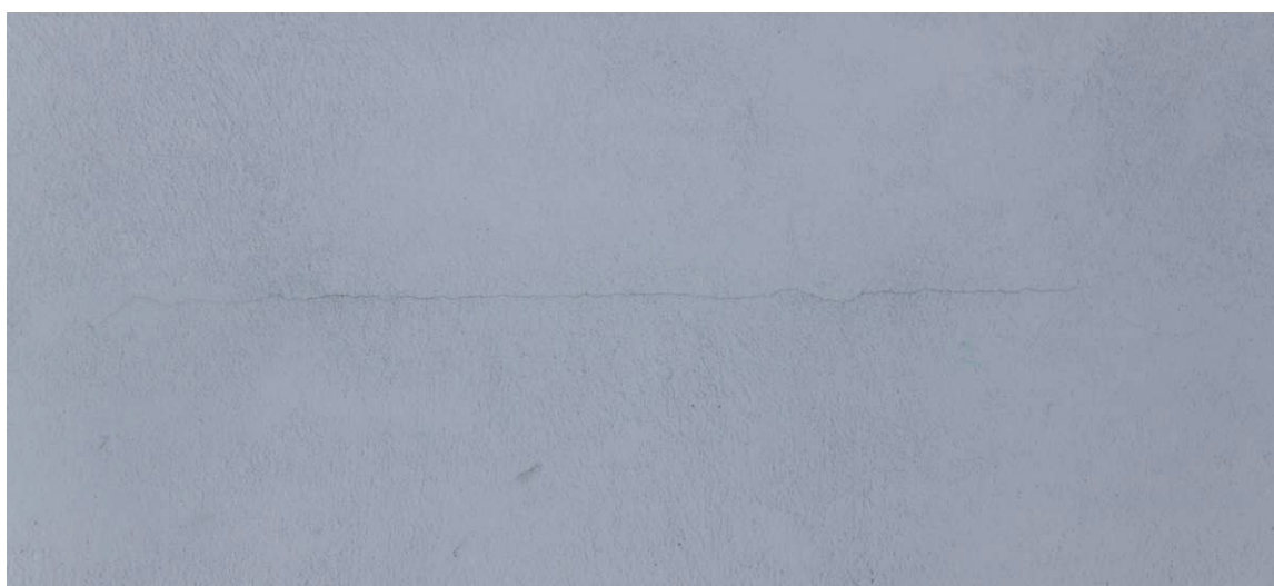
Rys. 3.24. Poziome zarysowanie górnej części korpusu podpory nr 6 – rozwartość do 0,2 mm
