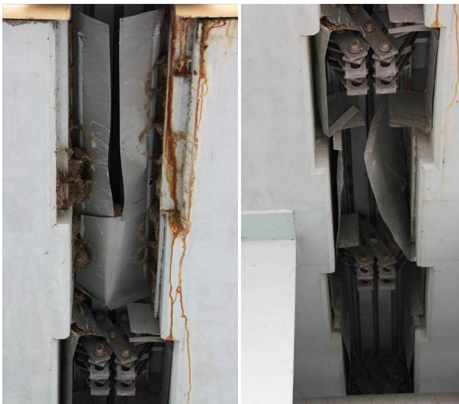
Rys. 3.36. Urządzenia dylatacyjne nad podporą nr 4 – ślady przecieków wody w otoczeniu urządzenia dylatacyjnego oraz deformacje blach osłonowych, (szalunkowych)
