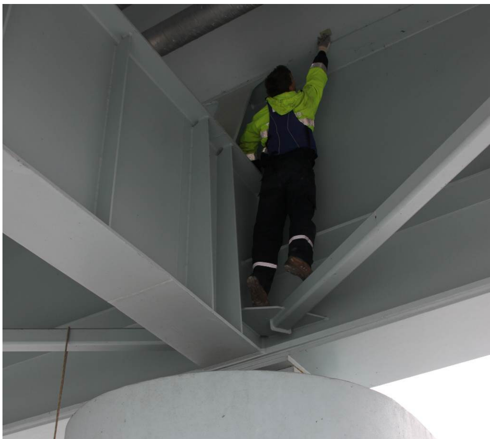
Rys. 3.17. Pomiar rozwartości rys w płycie pomostowej nad podporą nr 8 – stwierdzono rysy poprzeczne rozwartości 0,2 \div 0,3 mm
