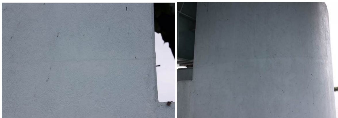
Rys. 3.21. Poziome zarysowania górnej części korpusu podpory nr 4 – rozwartość do 0,2 mm
