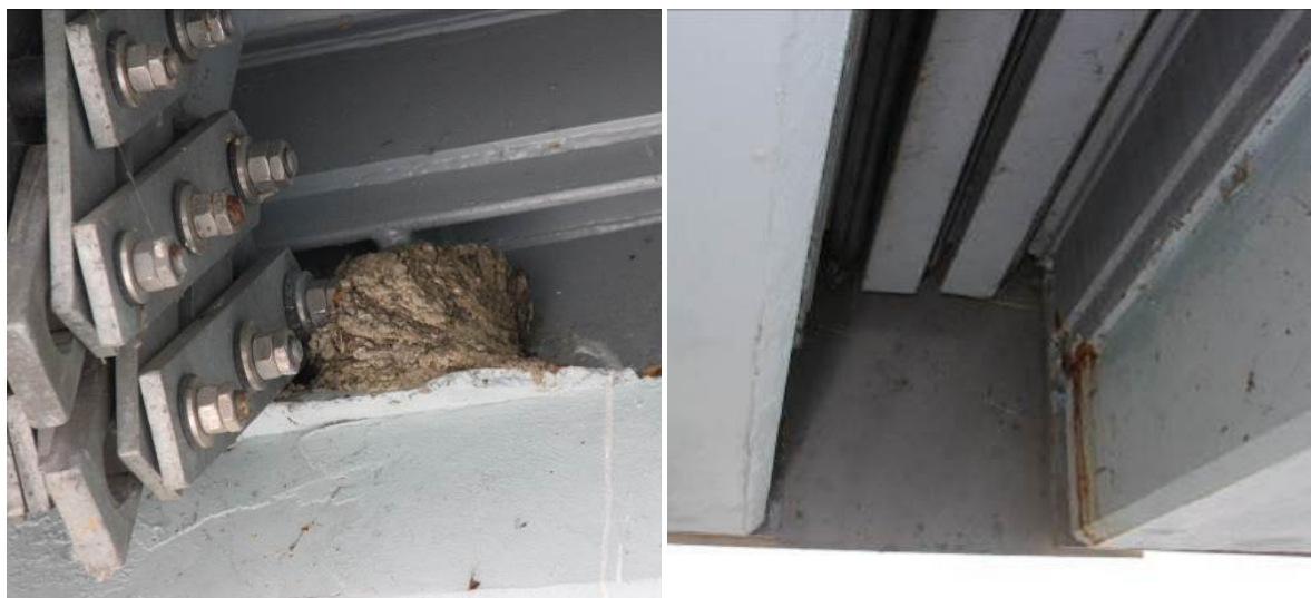
Rys. 3.40. Urządzenia dylatacyjne nad podporą nr 9 – widok od spodu, zanieczyszczenia (po lewej), ślady przecieków wody (po prawej)
