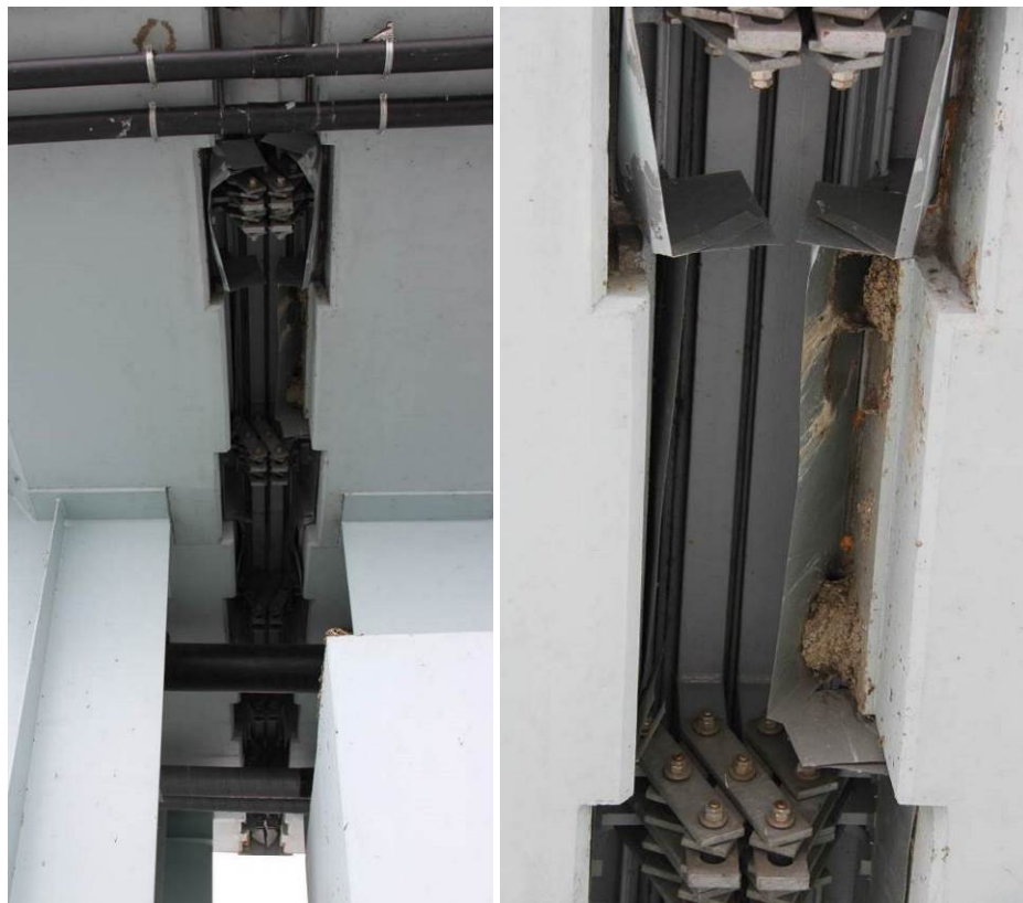
Rys. 3.37. Urządzenia dylatacyjne nad podporą nr 4: widok ogólny od dołu (po lewej) oraz zanieczyszczenia związane z gniazdami ptaków (po prawej)
