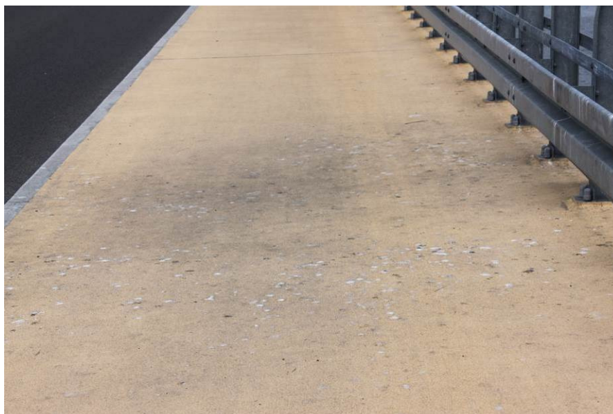
Rys. 3.31. Lokalne zanieczyszczenia organiczne związane z obecnością ptaków na obiekcie
