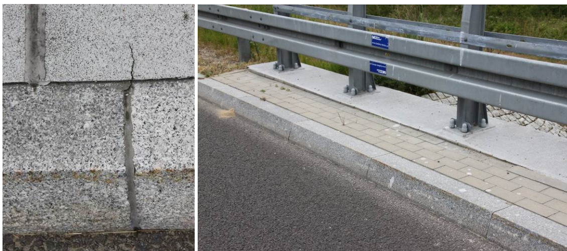
Rys. 3.30. Lokalne pęknięcie nawierzchni chodnika w strefie przykrawężnikowej (po lewej) oraz przemieszczenia i deformacje nawierzchni pasa bezpieczeństwa wzdłuż bariery w rejonie podpory nr 10 (po prawej)
