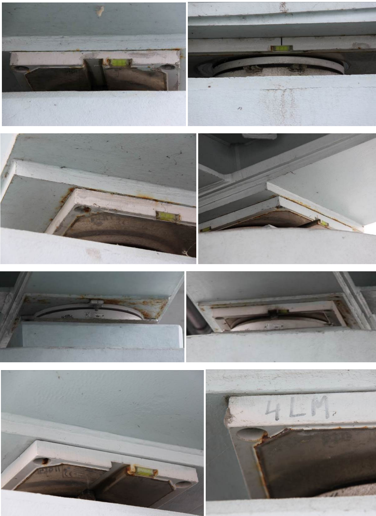
Rys. 3.27. Powierzchniowa destrukcja i ubytki materiału łożysk oraz blach nad łożyskami
