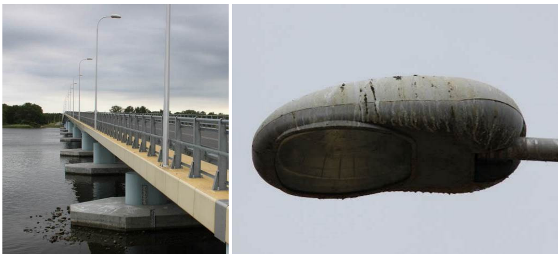
Rys. 3.44. Ogólny widok lamp oświetleniowych na obiekcie, zanieczyszczenie oprawy odchodami ptaków
