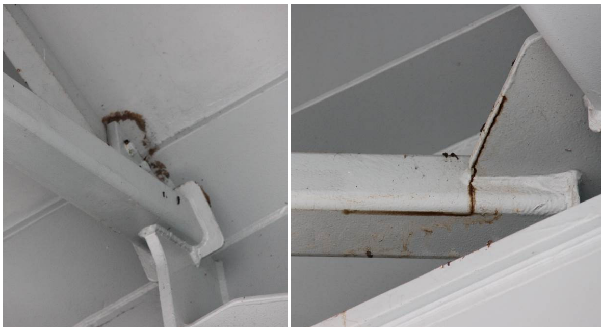
Rys. 3.15. Organiczne zanieczyszczenia elementów pomostu odchodami ptaków
