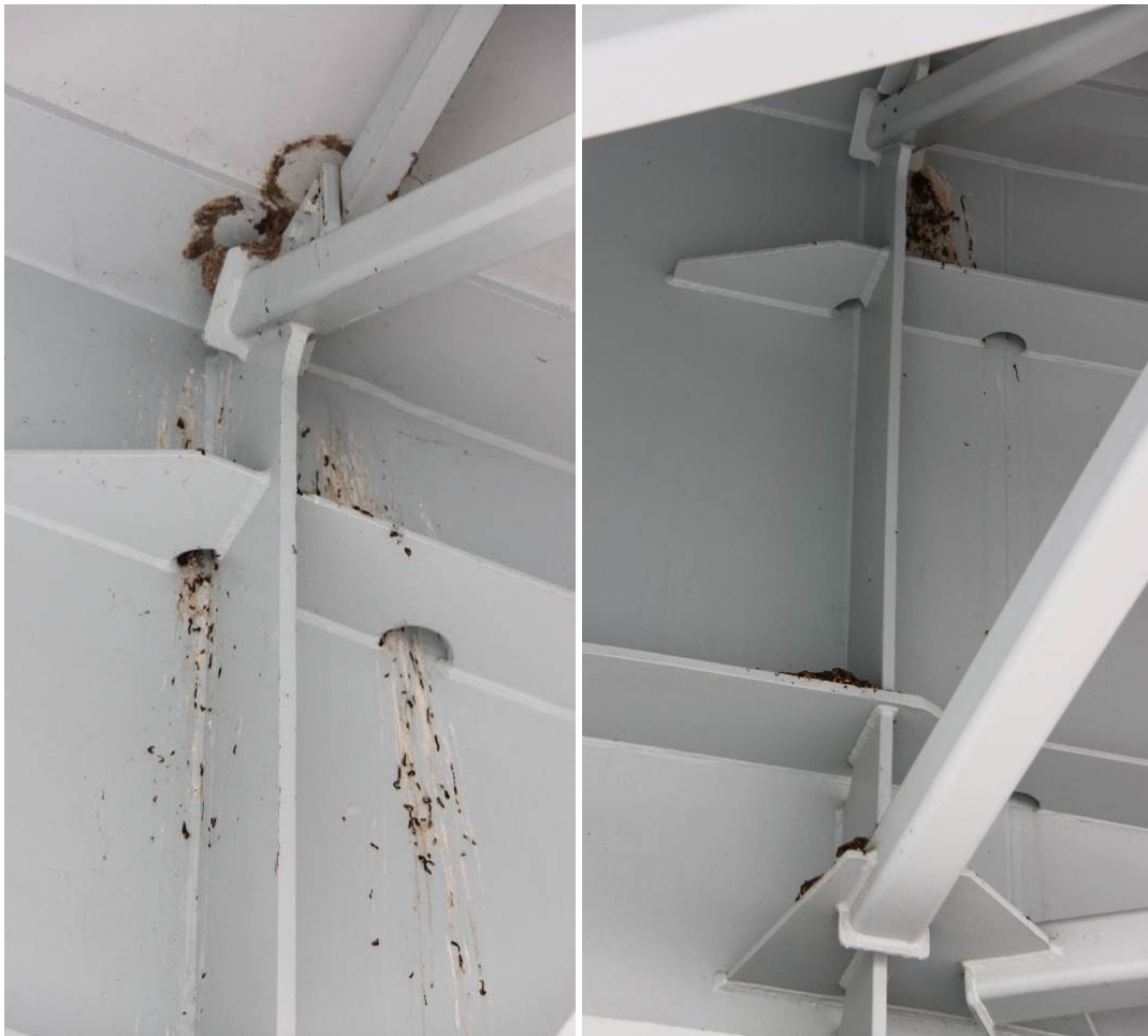
Rys. 3.9. Zanieczyszczenia organiczne dźwigarów głównych w przęśle 4-5
