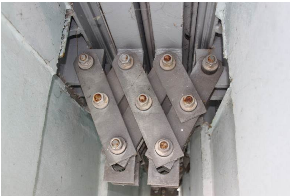
Rys. 3.38. Urządzenia dylatacyjne nad podporą nr 4 – uszkodzenia zabezpieczeń antykorozyjnych i początki destrukcji korozyjnej elementów urządzenia (korozja sworzni mechanizmu)
