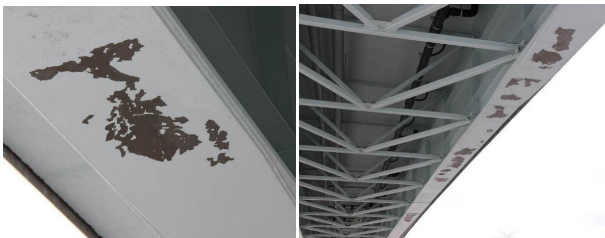
Rys. 3.5. Rozwarstwienia i ubytki zewnętrznej warstwy powłoki antykorozyjnej w przęśle 6-7 – widok na dolne pasy dźwigarów głównych: od strony dolnej wody (po lewej) oraz górnej wody (po prawej)
