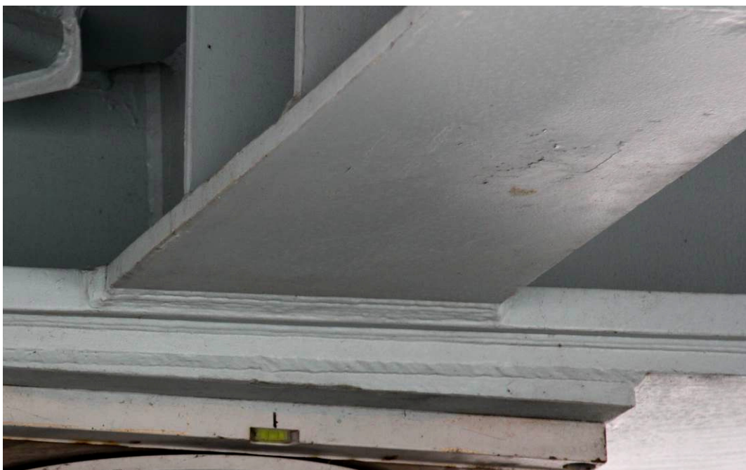
Rys. 3.13. Wstępne objawy lokalnej delaminacji i utraty ciągłości zewnętrznej warstwy powłoki antykorozyjnej – dolna półka poprzecznicy nad podporą nr 5
