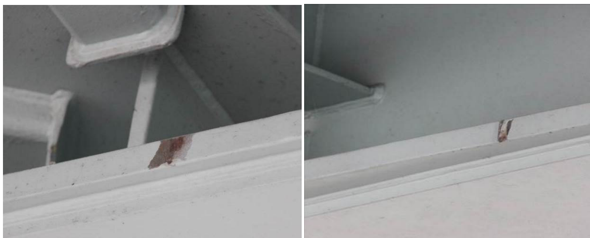
Rys. 3.8. Lokalne ubytki powłoki antykorozyjnej w przęśle 7-8 – możliwość rozwoju lokalnych ognisk korozji
