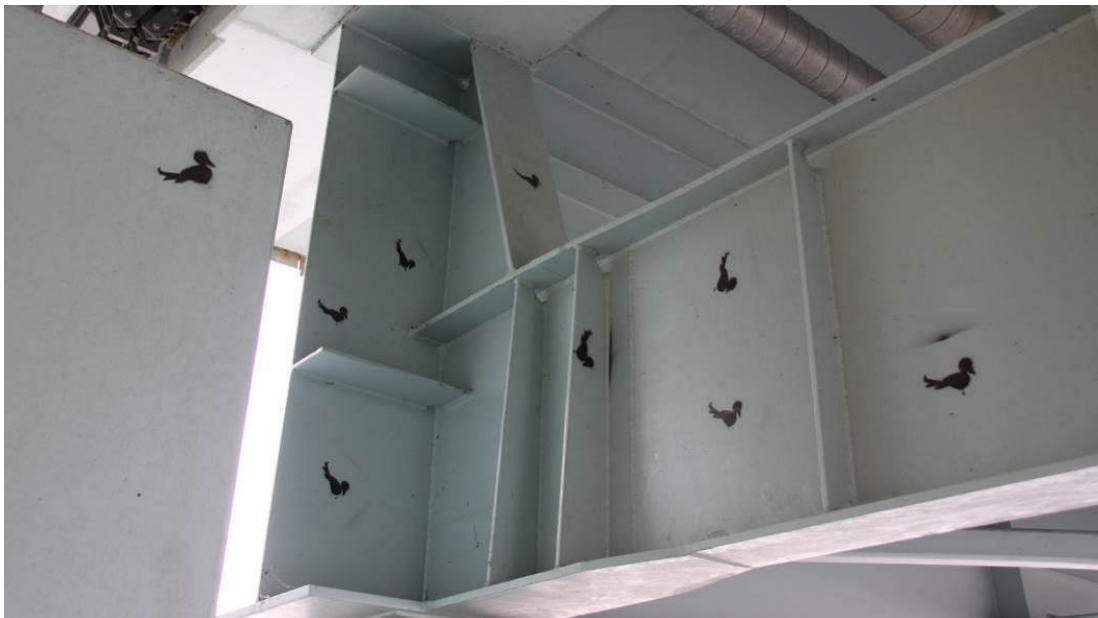
Rys. 3.10. Zanieczyszczenia nieorganiczne dźwigarów głównych nad podporą nr 9 (graffiti).
