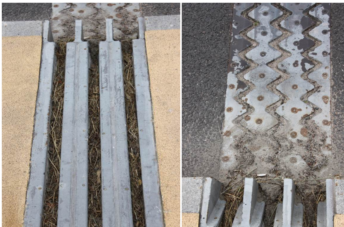
Rys. 3.39. Urządzenia dylatacyjne nad podporą nr 9 – widok z poziomu pomostu, zanieczyszczenia szczelin dylatacyjnych
