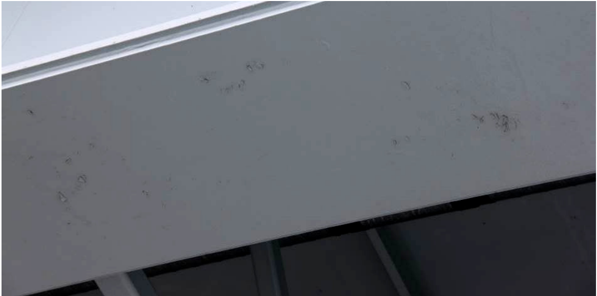
Rys. 3.2. Lokalne utraty ciągłości i destrukcja zewnętrznej warstwy powłoki antykorozyjnej dźwigarów głównych w przęśle 6-7 – widok od dołu na dolne pasy dźwigarów
