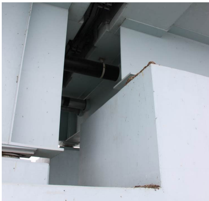
Rys. 3.25. Organiczne zanieczyszczenia korpusów podpór związane z bytowaniem ptaków (podpora nr 4)
