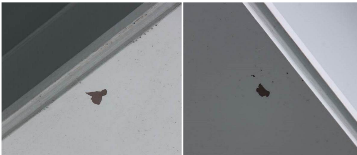
Rys. 3.7. Lokalne rozwarstwienia i ubytki zewnętrznej warstwy powłoki antykorozyjnej w przęśle 7-8 – widok na dolny pas dźwigara głównego od strony dolnej wody
