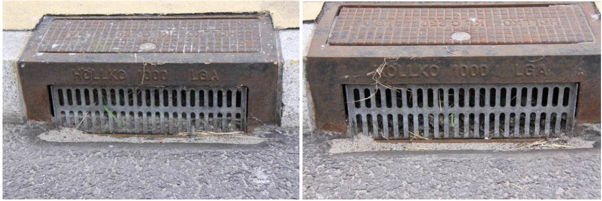
Rys. 3.32. Zanieczyszczenia wpustów odwadniających
