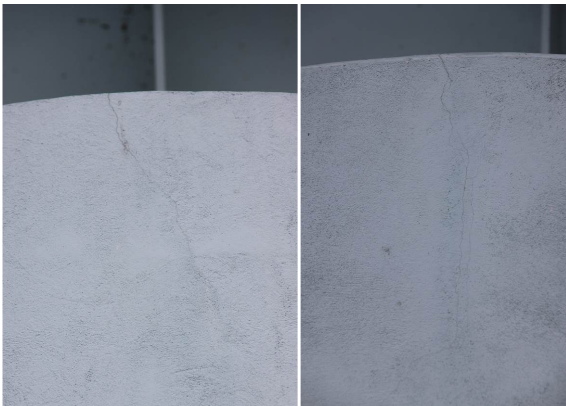
Rys. 3.23. Pionowe zarysowania rozwartości do 0,3 mm w górnej części korpusu podpory nr 5: słup od strony dolnej wody (po lewej) oraz od strony górnej wody (po prawej)
