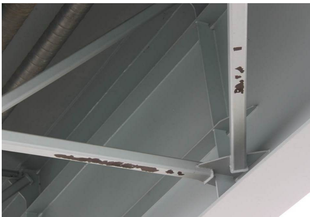
Rys. 3.14. Lokalne uszkodzenia zewnętrznej warstwy zabezpieczeń antykorozyjnych stalowych elementów stężeń poziomych w przęśle 7-8
