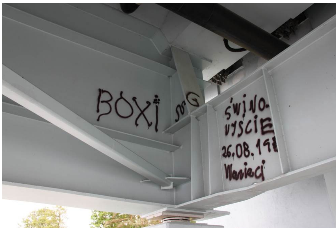
Rys. 3.16. Nieorganiczne zanieczyszczenia (graffiti) elementów pomostu w przęśle 9-10
