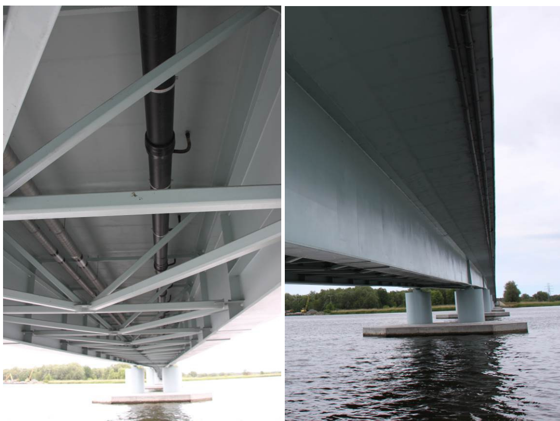
Rys. 3.47. Urządzenia obce zlokalizowane pomiędzy dźwigarami głównymi (po lewej) oraz na wsporniku od strony górnej wody (po prawej) – prowadzone na całej długości obiektu
