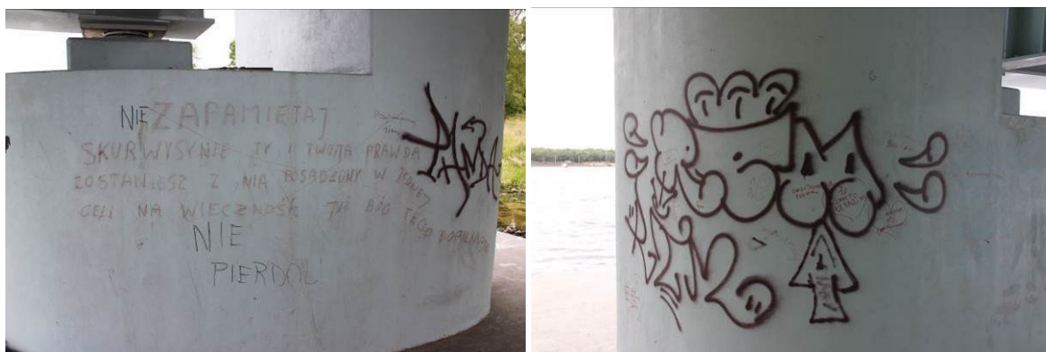
Rys. 3.26. Nieorganiczne zanieczyszczenia (graffiti) górnej części korpusu podpory nr 9
