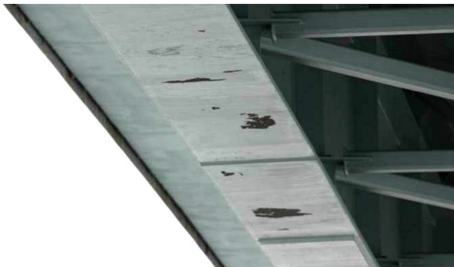
Rys. 3.6. Rozwarstwienia i ubytki zewnętrznej warstwy powłoki antykorozyjnej w przęśle 6-7 – widok na dolny pas dźwigara głównego od strony dolnej wody
