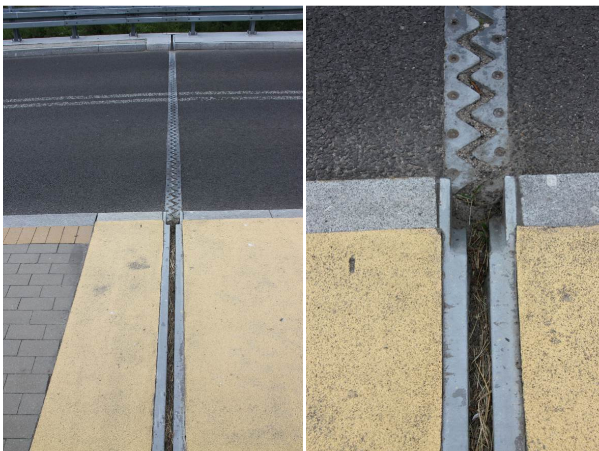
Rys. 3.41. Urządzenia dylatacyjne nad podporą nr 10 – widok z poziomu pomostu, zanieczyszczenia szczelin dylatacyjnych
